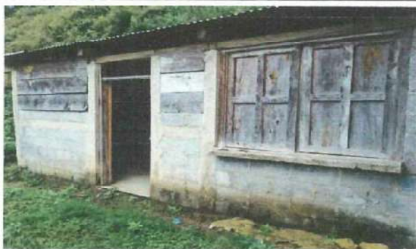
Foto 1: El módulo de la cocina que amerita sustitución de cubierta de lámina y de estructura de techo, además complementar la pared de block.
