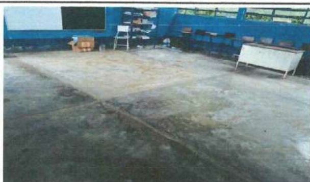
Foto 4: El piso de torta de concreto de las aulas se encuentran en mal estado que requiere de sustitución.
