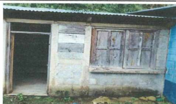
Foto 2: El módulo de la cocina requiere repellado de pared, sustitución de puerta y ventana de madera por metal.
