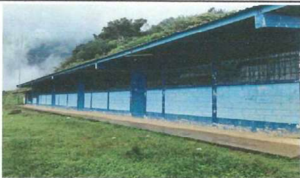
Foto 3: En la parte frontal del módulo de la escuela amerita ampliación de la cubierta de lámina, debido que en invierno penetra la lluvia en las aulas.
