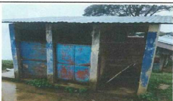
Foto 6: El módulo de los sanitarios se encuentra en malas condiciones y requiere de mejoras en su estructura.
